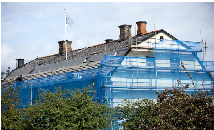
Med flaggan i topp påbörjades renoveringen av Företagarnas Hus i september förra året. Den tvåhundraåriga fasadens ansiktslyftning förmådde sen inte ens rykande snöstorm att dölja.
